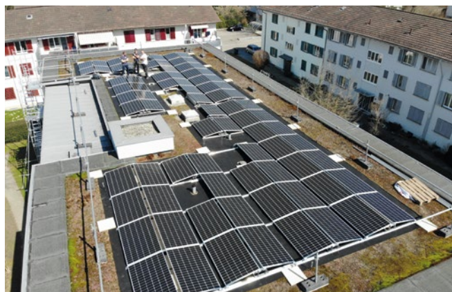
Solarstromanlage auf den Dächern der Siedlung Zwinglistrasse: Neu ist es ökologisch und finanziell sinnvoll, wenn die Bewohnerinnen und Bewohner tagsüber Strom brauchen – vor allem, wenn die Sonne scheint.
