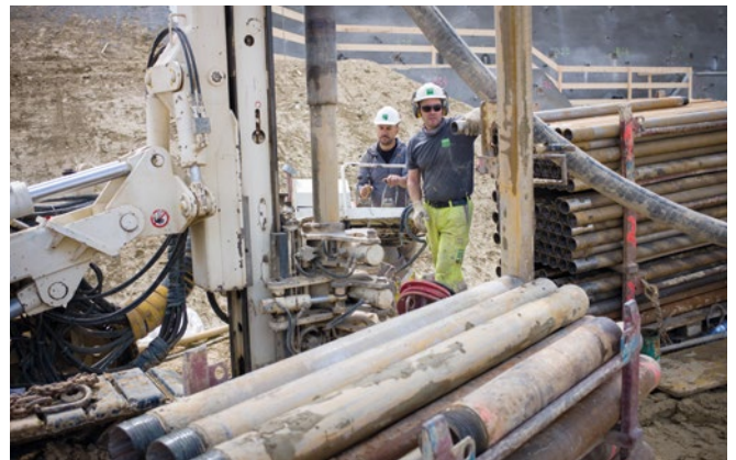
Die Siedlung Vogelsang wird mit Erdsonden beheizt. Die Wärme wird durch 41 Rohre, die je 250 Meter in die Tiefe reichen, aus dem Boden geholt und erwärmt Wohnungen und Wasser. Im Sommer wird die Wärme wieder in den Boden geleitet. Die Wohnungen werden gekühlt.
