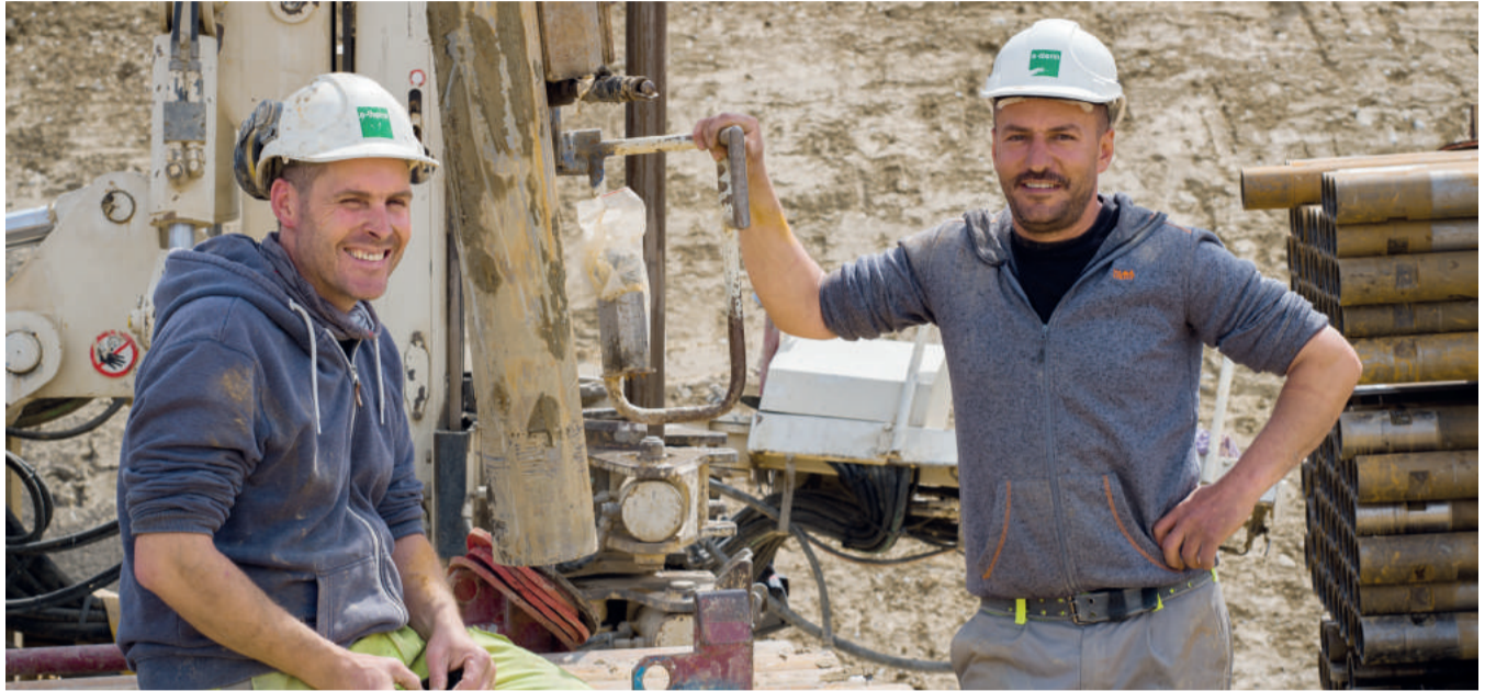
Bohren nach Wärme aus der Tiefe: Dieses Bohrteam der Firma e-therm sorgt dafür, dass es dank Erdsondenheizung im neuen Vogelsang zu jeder Jahreszeit in der Wohnung gemütlich ist. Fotos: PB
