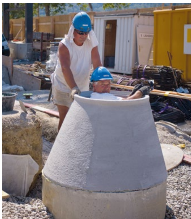
Sieht aus wie ein Badebrunnen – ist aber «nur» ein Betonrohr für einen Kanalisationsschacht, das im Hochsommer zumindest für etwas Abkühlung sorgte.
