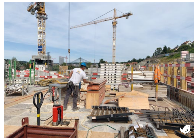
Die Holzschalung für die Tiefgaragendecke wird in Handarbeit erstellt. Sie muss stabil und dicht sein, denn darüber wird zuerst die Eisenbewehrung verlegt und danach der Beton gegossen. Foto: GV
