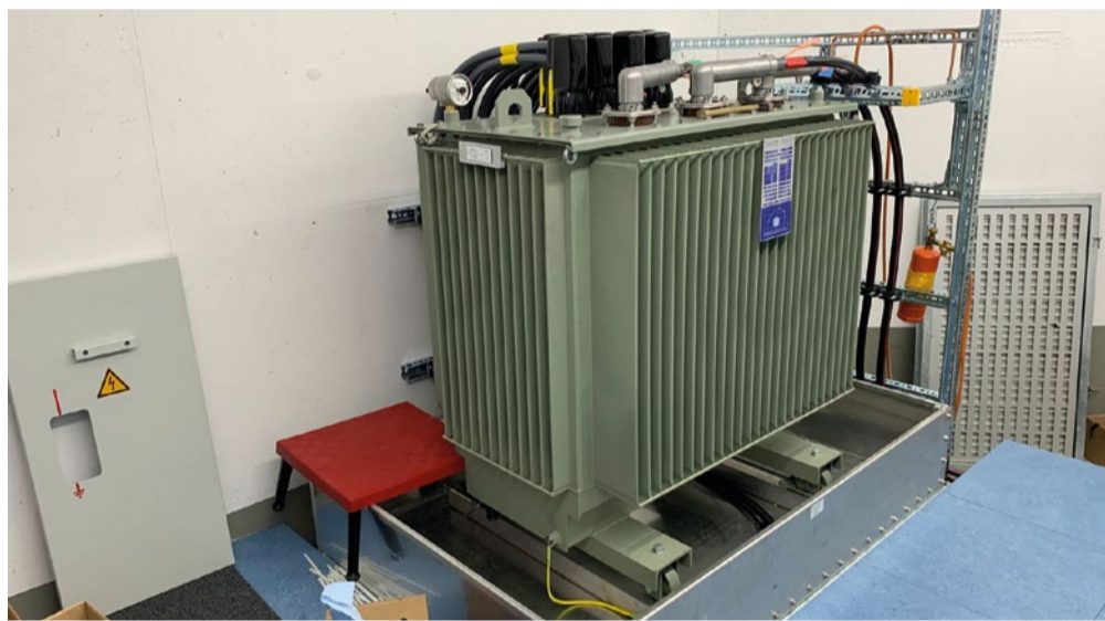
Der Trafo – Namensgeber des Traforaums. Er dient der Spannungsumwandlung und ermöglicht die Verteilung von Strom durch den Niederspannungsverteiler. Fotos: GV
