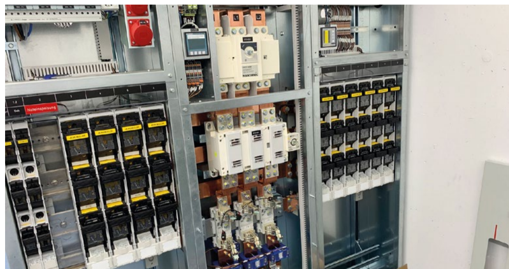
Viele Schalter und Hebel: der Niederspannungsverteiler hat eine zentrale Funktion im elektrischen Netz. In ihm sind verschiedene Sicherheits- und Schaltelemente zur Verteilung von Strom untergebracht.
