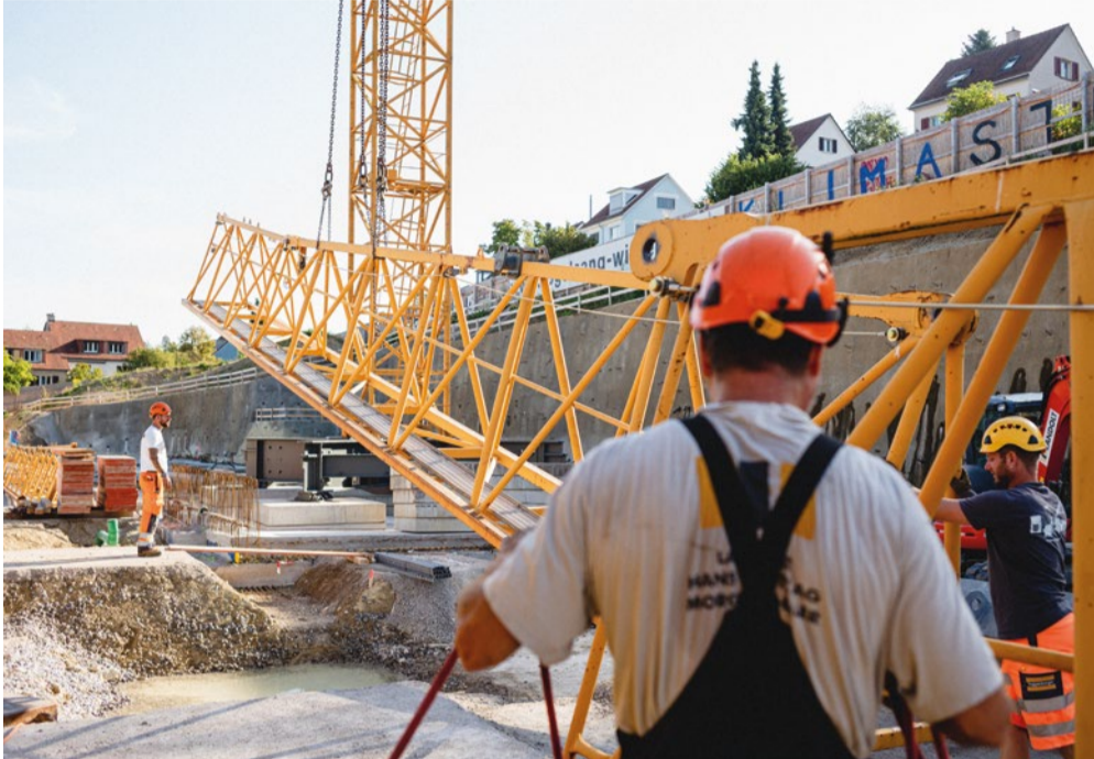
Schon der Aufbau eines Krans ist Zentimeterarbeit. Dieser hier wird etwa 40 Meter hoch, der Ausleger 50 Meter lang. Mit Hilfe eines ausfahrbaren Pneukrans werden die einzelnen Teile auf einem Betonfundament zusammengebaut. Foto: MA
