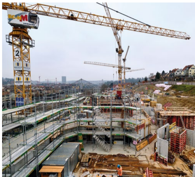
Die Gerüste werden für das Erstellen der Aussenwände und Decken benutzt und müssen daher sehr früh erstellt werden. Fotos: MR
