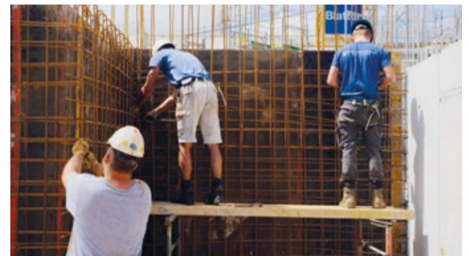
Bevor der flüssige Beton in die Schalung gegossen wird, muss die Eisenbewehrung (Armierung) an die richtige Stelle platziert werden. Sie übernimmt die Druck- und Zugkräfte, welche auf das Bauteil einwirken.
